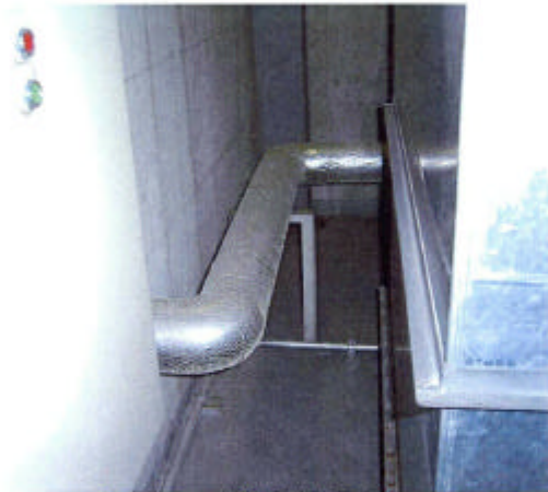
アリオレス装着箇所 上水給水本管100A
