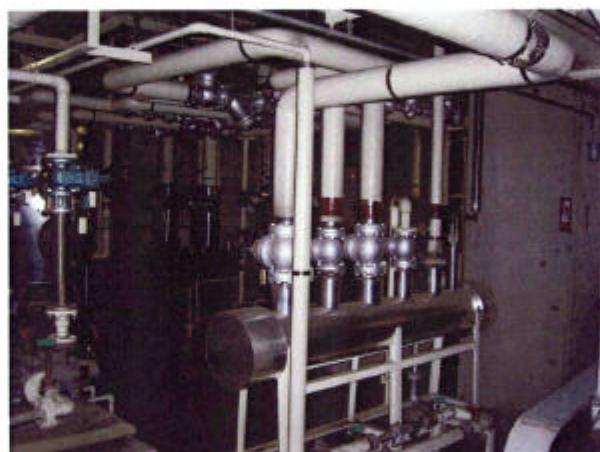
給湯用貯湯槽
