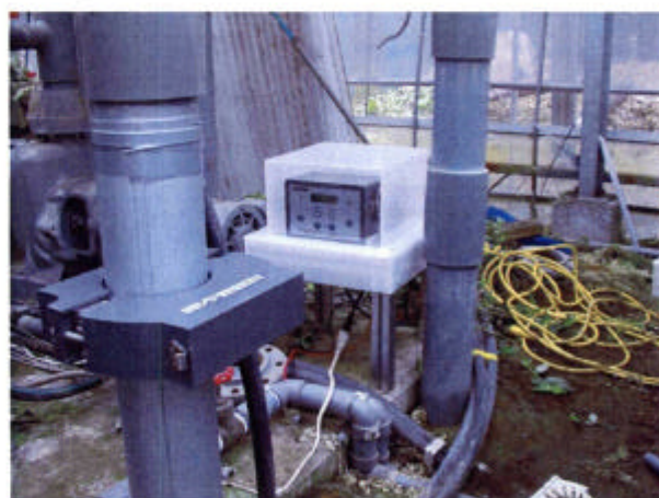
井水循環給水配管 アリオレスL型100A装着
