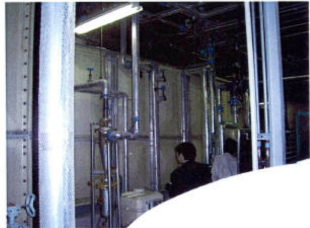
アリオレス装着箇所(40A) 井水給水配管
