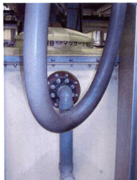
採水場所(ブロー貯湯槽)
