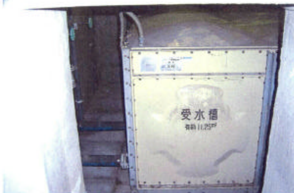
地下受水槽室
