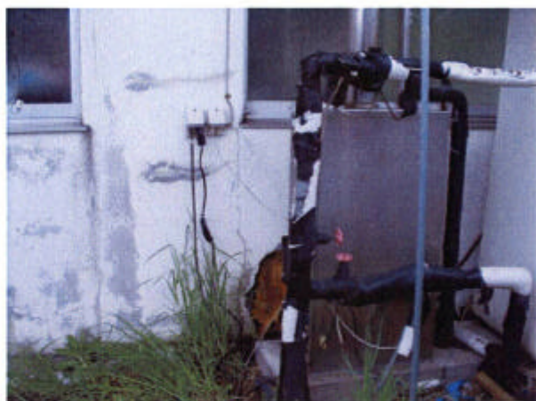
屋外コンセント
