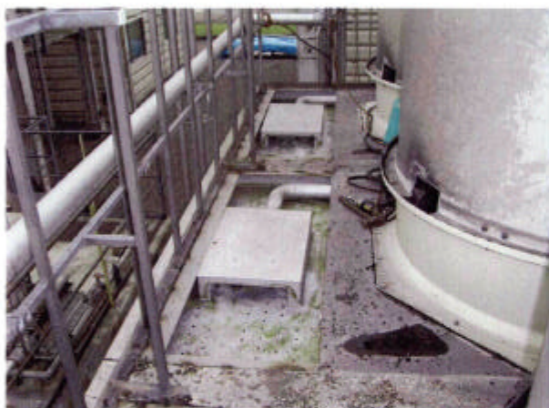
冷却塔上表部
