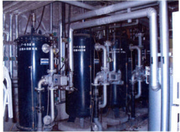
ボイラー室内ろ過機
