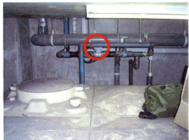
上水給水配管
