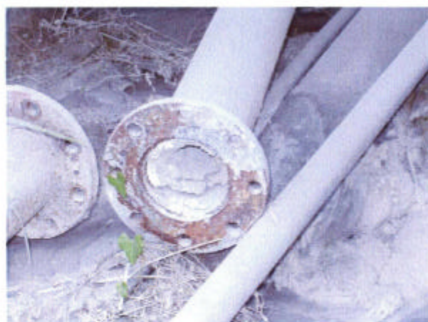
配管内閉塞物
