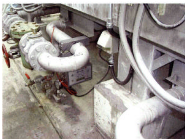
CT-851C冷却水(還)配管
