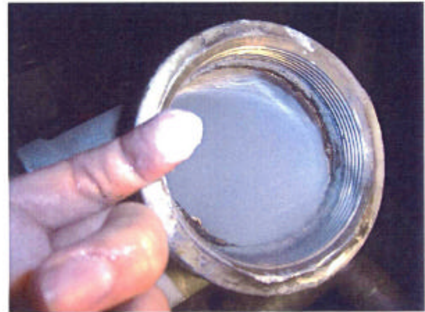
配管内付着スケール
