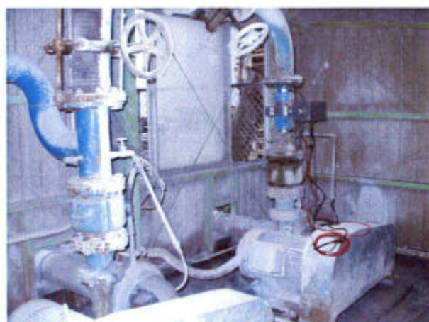
循環圧力ポンプ
