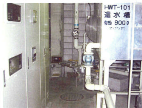
貯湯槽アリオレス磁界部設置
