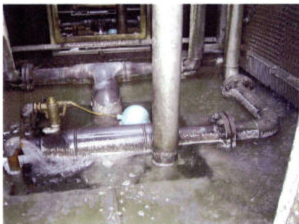
CT-851C冷却塔内部
