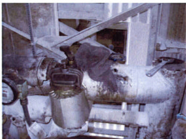
重油給油配管
