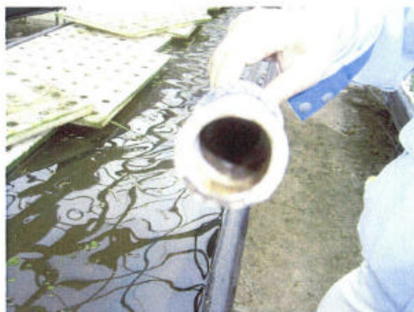
配管内付着スケール
