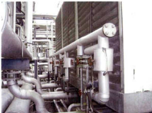
冷却塔散水系設備
